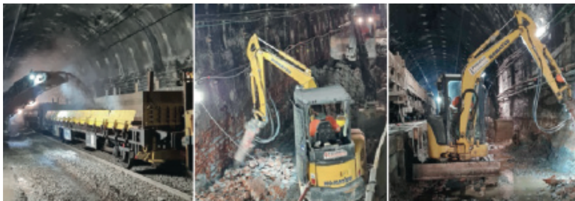
Prima fase di demolizione del camminamento esistente con utilizzo fresa stradale e convoglio ferroviario per trasporto materiale di risulta - Fase di demolizione fino al raggiungimento della quota di imposta del nuovo arco rovescio in calcestruzzo armato.
