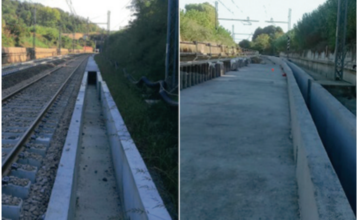
Realizzazione canali per regimentazione delle acque, imbocco lato Arona - Realizzazione soletta di fondo per proteggere la nuova massicciata ferroviaria, imbocco lato Alessandria.
