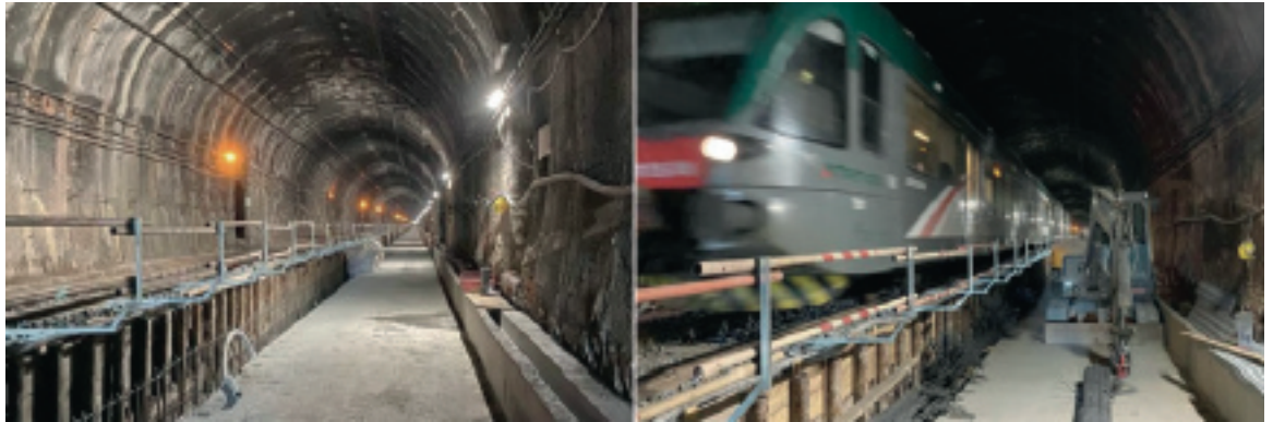
Impianto minimel 95 del sistema ATWS in funzione con evidenti le lampade accese - Passaggio del treno in adiacenza all'area di lavoro
