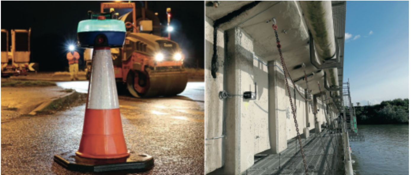
Dotazione di cantiere digitalizzata - Monitoraggio strutturale continuo
