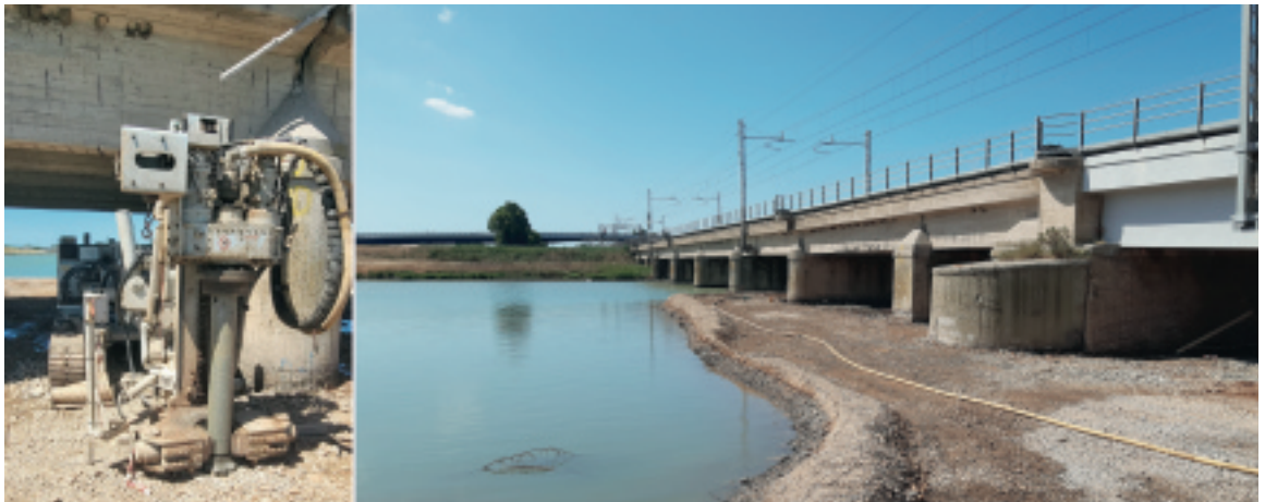
A sinistra: macchina perforatrice adatta a lavorare in altezze ridotte - a destra: pista da cantiere
